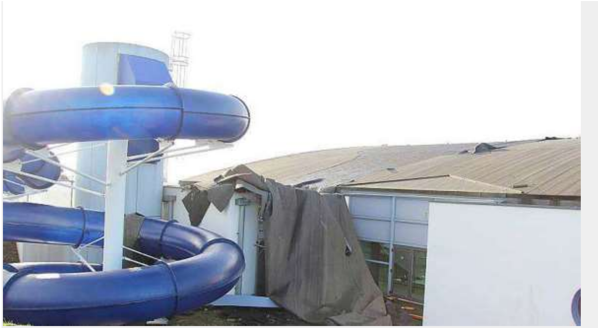
Un tiers de la gomme d'étanchéité qui recouvre le toit de la piscine de Binic a été arraché par le vent samedi. | FABIENNE RICHARD
