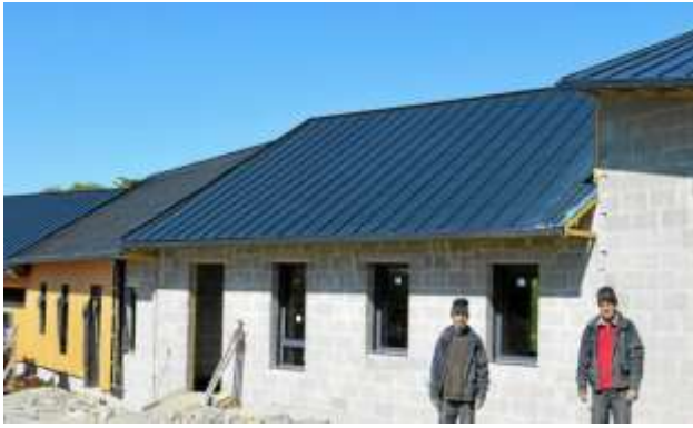
Arrêté le 17 mars, le chantier de la nouvelle école des Lutins, à Plœuc-L'Hermitage, a repris mi-avril. (DR)
